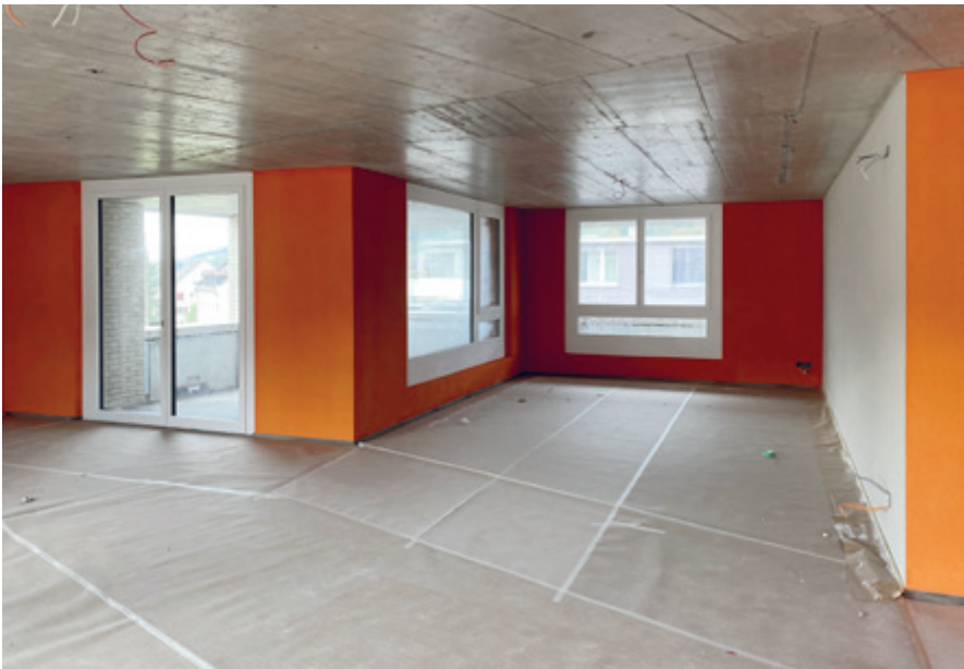
Wohnzimmer und Küche im Wohnbereich orange
