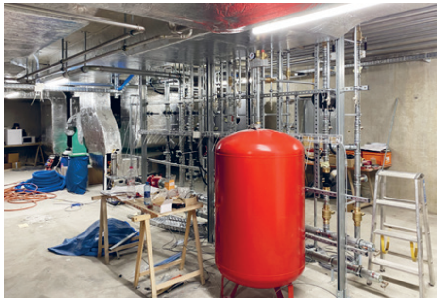
Lüftungs- und Heizungszentrale
