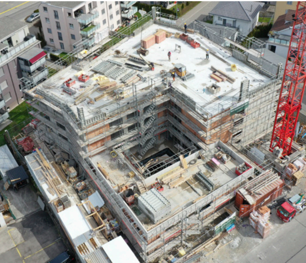
Almacasa Pfungen, Bauzustand 9. April 2021: Der Rohbau ist erstellt – im Vordergrund das Bistro, im Hintergrund der Wohnbereich.
