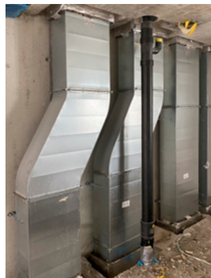
Lüftungskanäle und eine Abwasser- leitung
