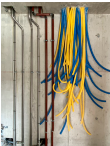
Warmwasser-, Kaltwasser- und Heizungsrohre, Kabelkanäle
